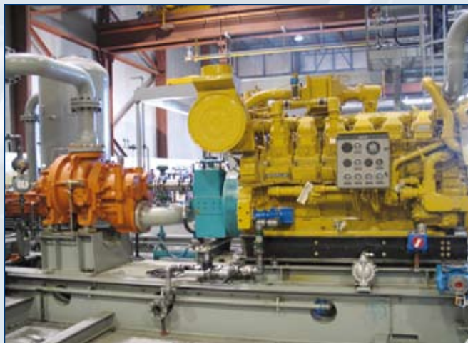
Pumpenantrieb / pump drive
